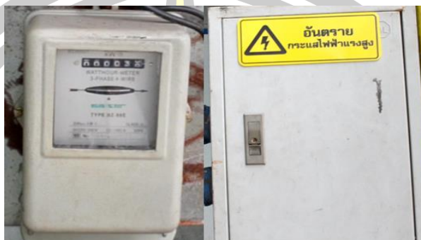
ภาพประกอบ 67 ตู้คอนโทรลไฟฟ้าและมีเตอร์วัดกระแสไฟฟ้า
