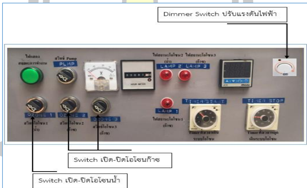
ภาพประกอบ 49 แผงควบคุมระบบโอโซน
