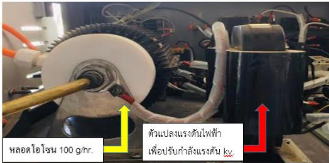
ภาพประกอบ 50 ชุดแปลงไฟฟ้าระบบไอโซน
