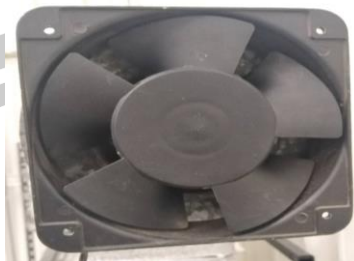
ภาพประกอบที่ 3.20 พัดลมระบายอากาศ
