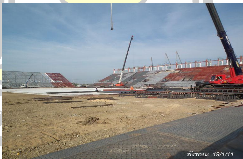
ภาพประกอบที่ 3 กำลังดำเนินการก่อสร้างสนามช้างอารีน่าปี 2011
