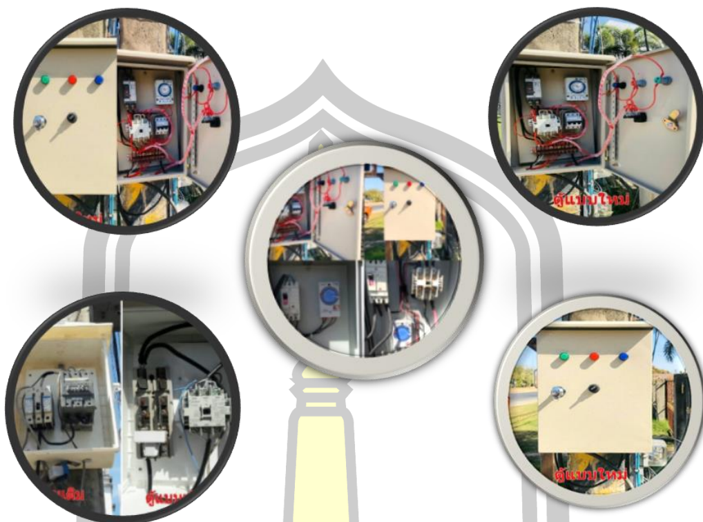
ภาพประกอบ 3.2 แสดงตู้คอนโทรลไฟถนนสาธารณะเทศบาลเมืองมหาสารคาม
