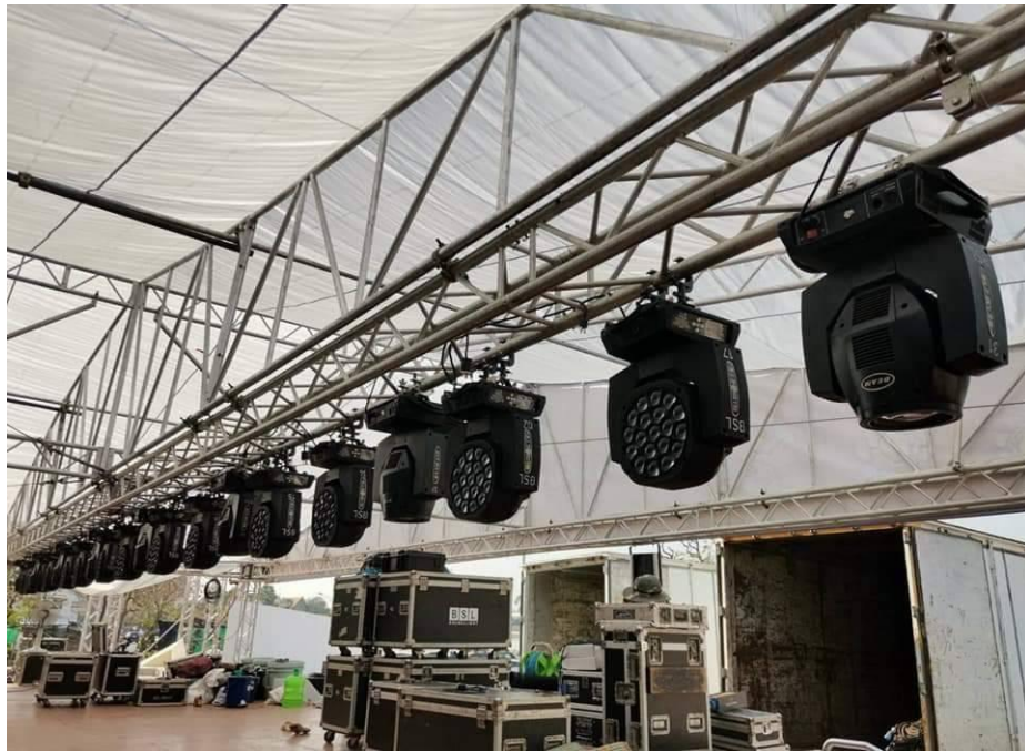
ภาพประกอบที่ 53 อุปกรณ์ไฟเวทีและระบบแสงเวที ที่มา : ผู้วิจัย
