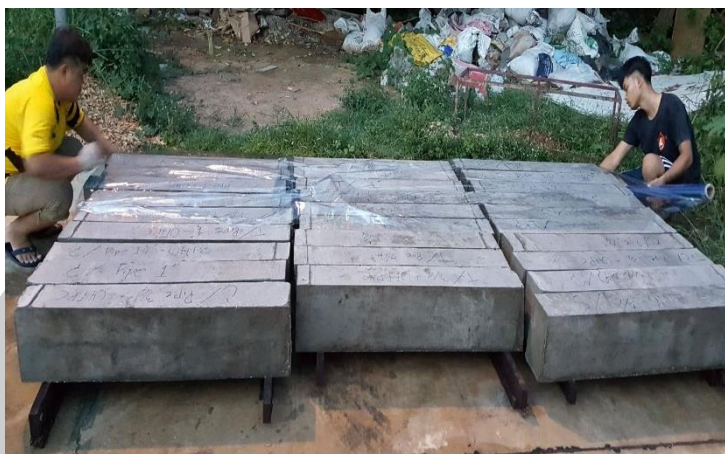
ภาพประกอบ 23 การบ่มเสาคอนกรีตด้วยพลาสติกใส
