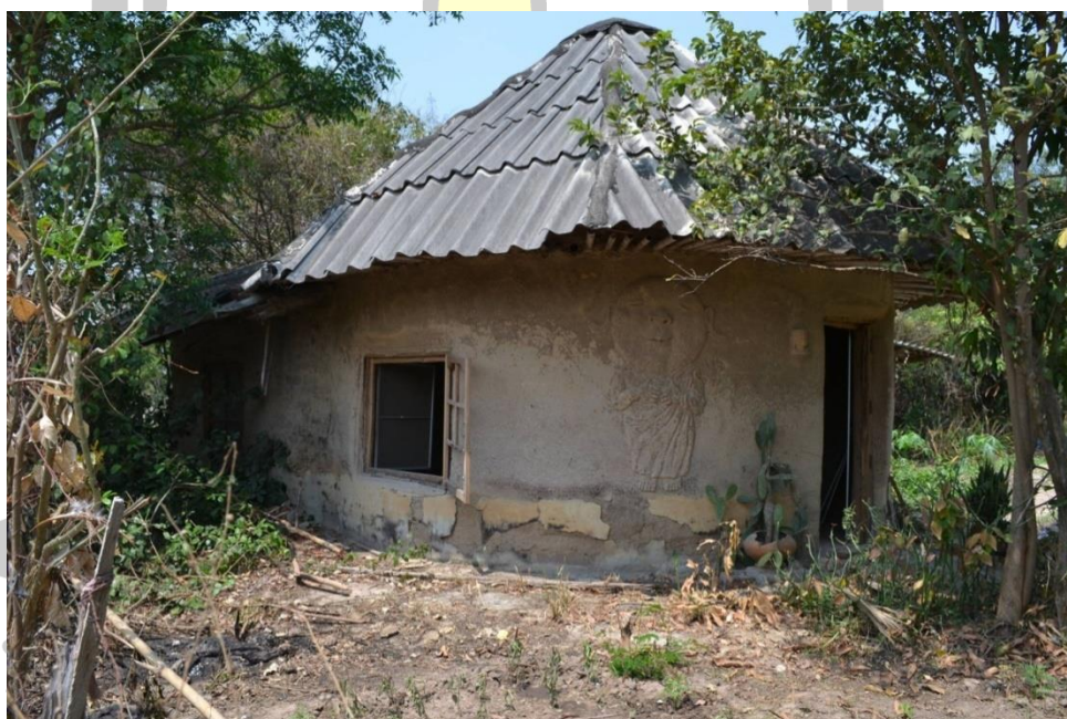
ภาพประกอบ 75 บ้านดินสองชั้น ของโจนจันโต บ้านศรีฐาน จังหวัดยโสธร
