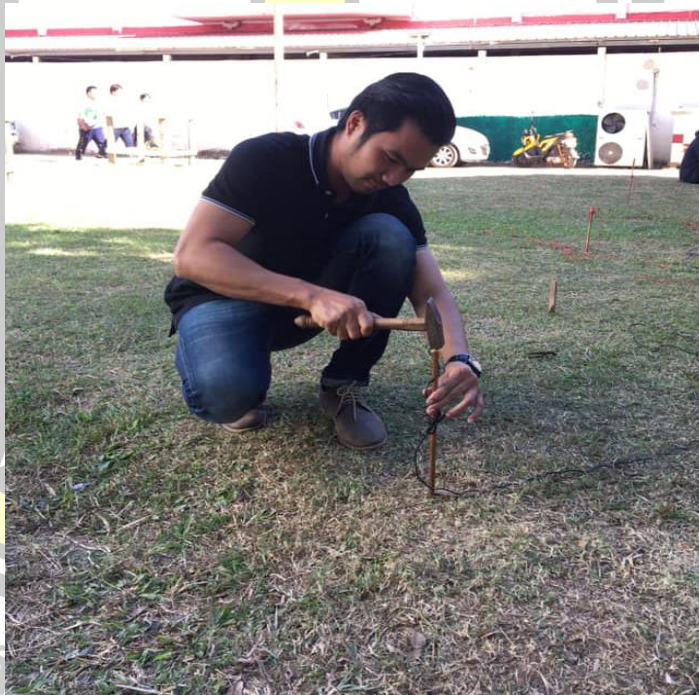
ภาพประกอบที่ 4.13 ทำการฝังขั้วไฟฟาลงไปในดินที่จะทดสอบ
