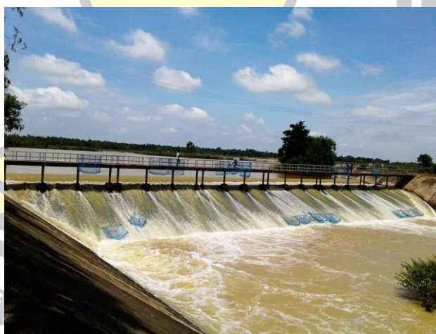
ภาพประกอบ 88 ฝายน้ำล้นโครงการชลประทานราชดำริ บ้านกระทุ่ม ตำบลสูงเนิน อำเภอกระสัง จังหวัดบุรีรัมย์
