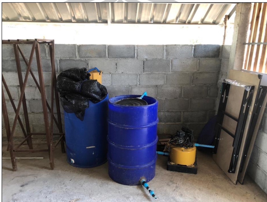
ภาพประกอบ ค1 อุปกรณ์ในการติดตั้งระบบ Reverse A2O – MFCs
